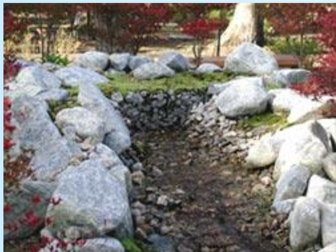
雨水貯留滲透設施
