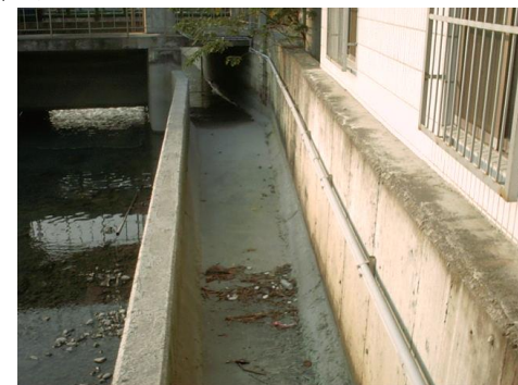
荊仔埤圳分往舊濁水溪之水圳路
