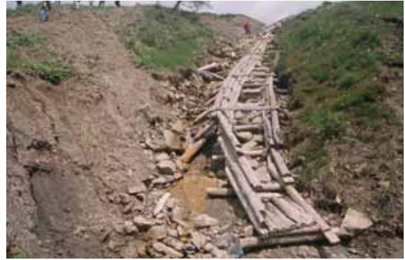
義大利之木製洩槽（已損毀）（作者攝）
