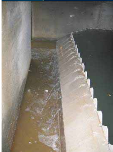
污水經污泥槽存槽後流出
