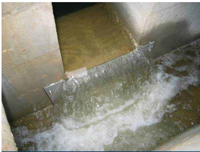
污水經礫間淨化槽 流至出流渠道
