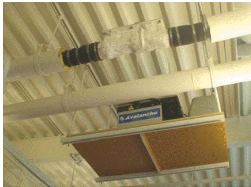
附屬於綠屋頂排水管的水槽流量計和水質採樣儀
