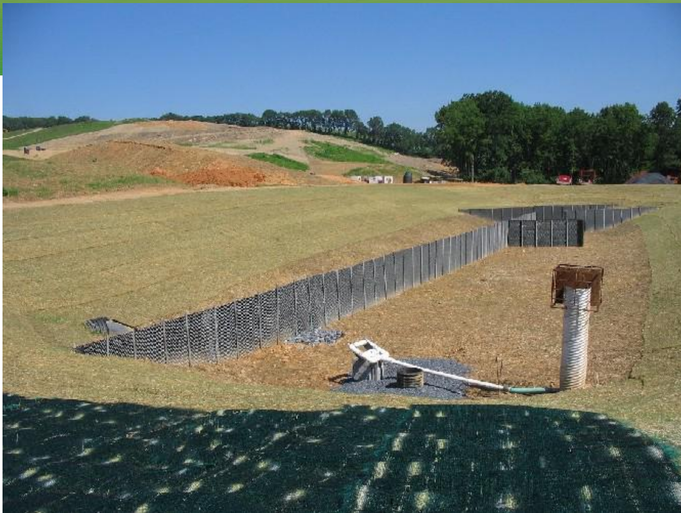
溢流管式排水沉砂池
