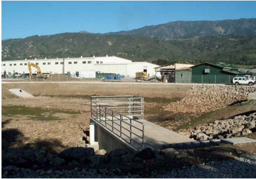
溢流堰式排水沉砂池
