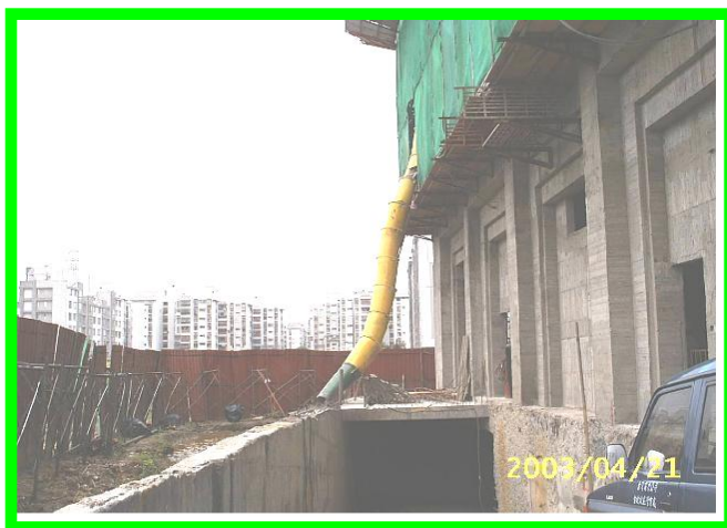
密閉輸送管道
