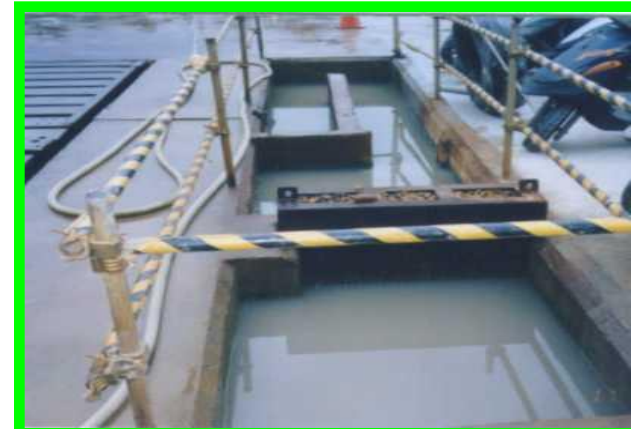
洗車台應設置沈砂池，妥 善處理廢水
