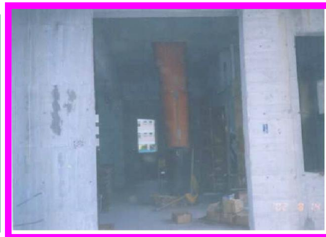
建築物內部管道
